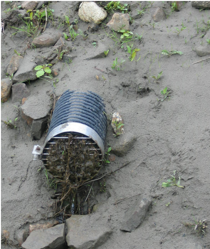
Photo 3 : Grille partiellement obstruée Source : Mikael Guillou (MAPAQ)
