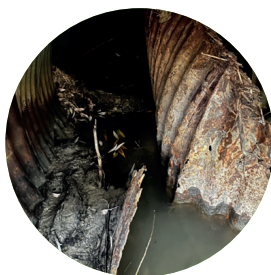
Déchirure visible de la canalisation
