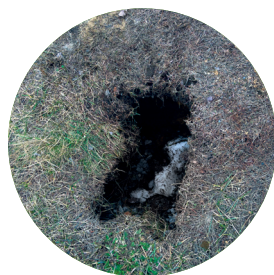
Affaissement du sol au-dessus de la canalisation
