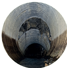
Écrasement important de la canalisation
