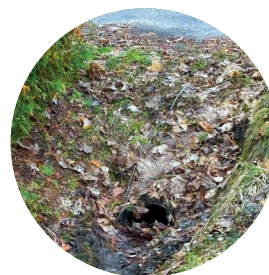
Incapacité d'effectuer le nettoyage ou l'entretien de la canalisation
